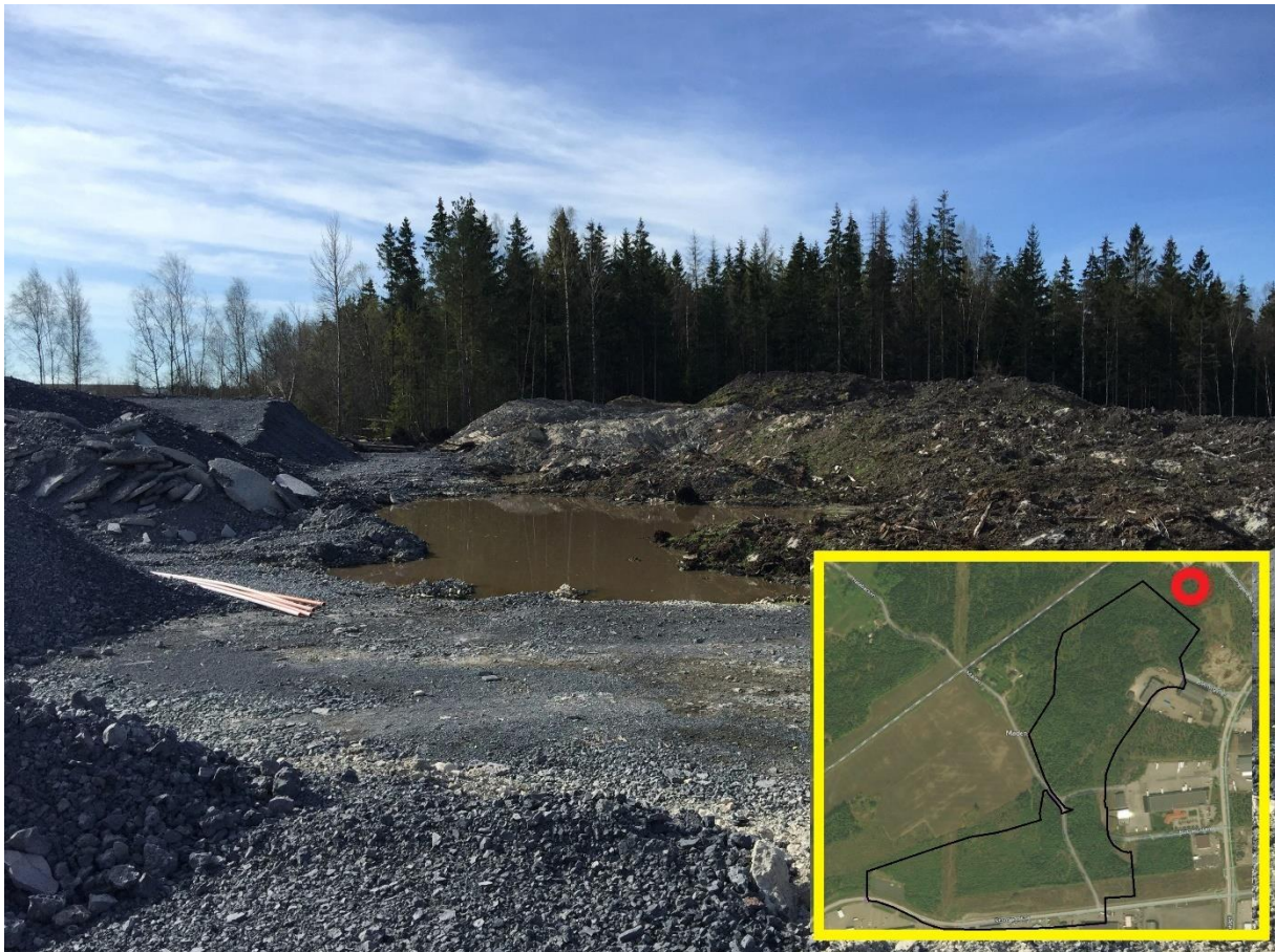
Figur 3 Vatten står högt i byggarbetsplats för expansion av den befintliga industrin, precis utanför planområdets gräns, markerat i rött.
